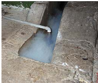
Tuberías en mal estado generan pérdidas de agua
