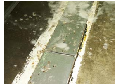
Es importante mantener las rejillas en buen estado. Cuando se encuentran dañadas, provocan la incorporación de desechos sólidos en el efluente.
