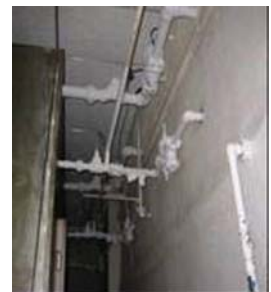
Tuberías sin aislamiento disminuye la eficiencia del refrigerante
