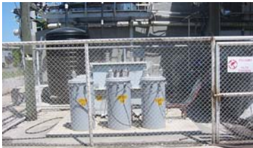
Transformadores en una planta procesadora. El uso racional de la energía eléctrica juega un papel importante en el tema de Producción más Limpia.
