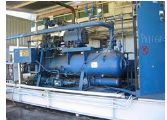
Compresor para refrigeración.
