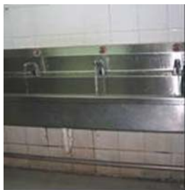
Sistemas de lavado de flujo centralizado provoca derroche de agua
